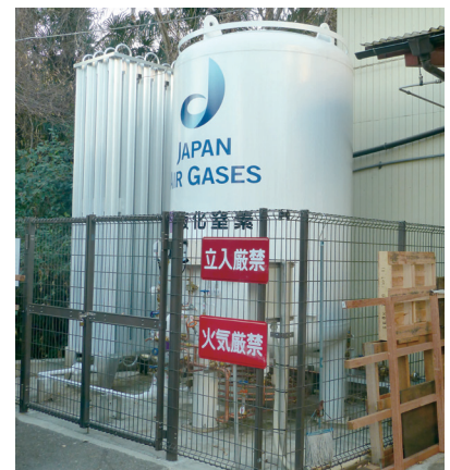
2012年1月に液体窒素タンクの設置が完了
