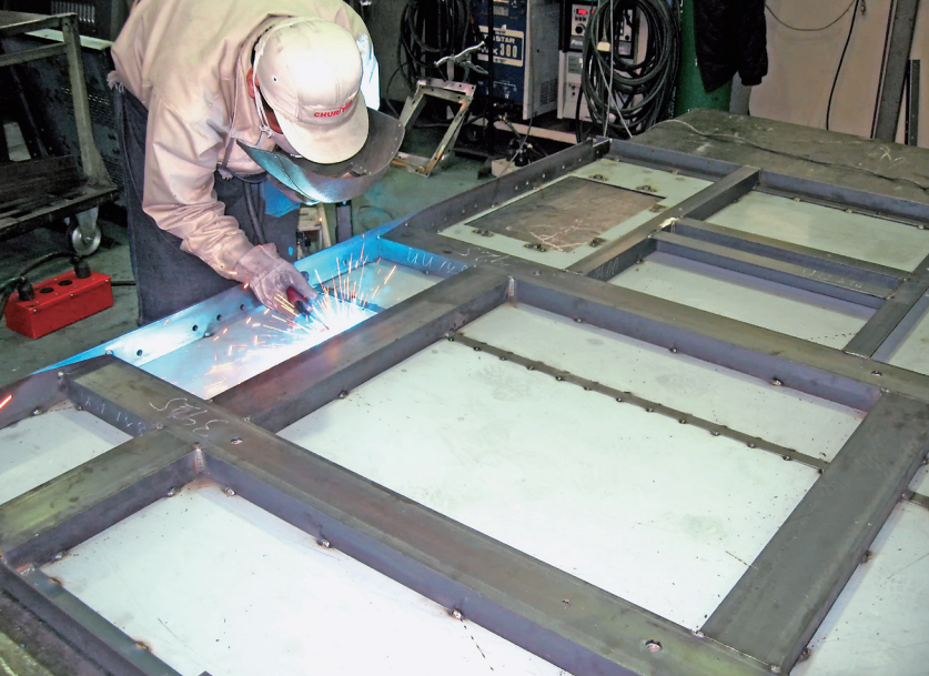
天板や側板といった各部材に補強材や各種取付具が溶接される
