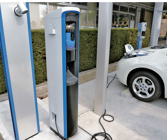
EVの充電スタンドでEVが充電中
