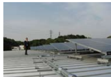
工場屋上には600㎡に及ぶ太陽電池が設置され自家発電による環境負荷低減に努力する。年内にはさらに600㎡を増設する。
