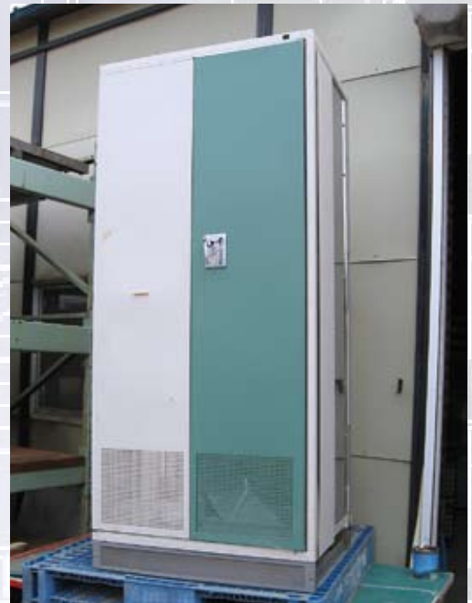
出荷されたのと同型の分電盤。下部のスカシ部分はEMLで細かくパンチされている。
